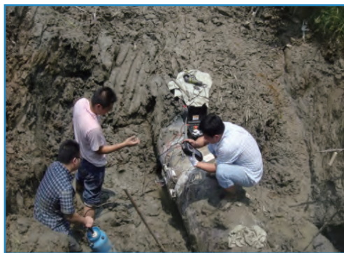
中石化长输管线自动腐蚀检测
