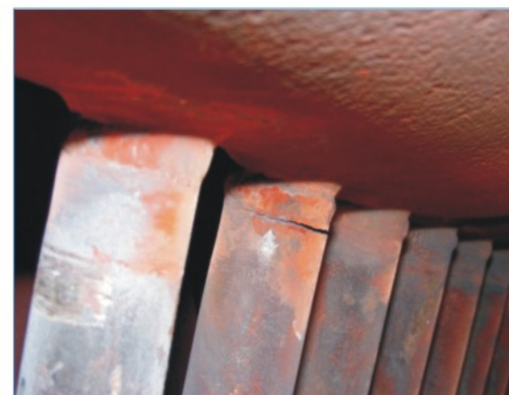
热回收蒸汽发生器泄漏
