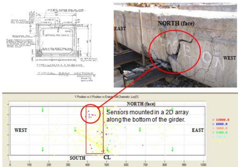
混凝土桥梁或水泥板的可见/不可见裂纹及腐蚀
