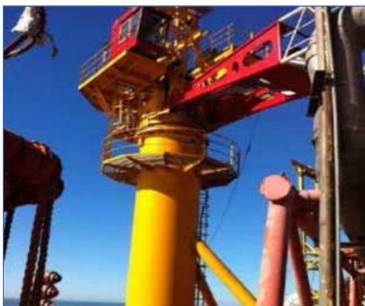
海洋平台吊机焊缝监测
