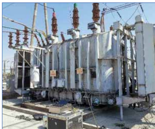
110KV变压器局部放电监测
