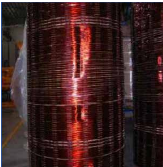
抽水蓄能电站变压器声发射检测
